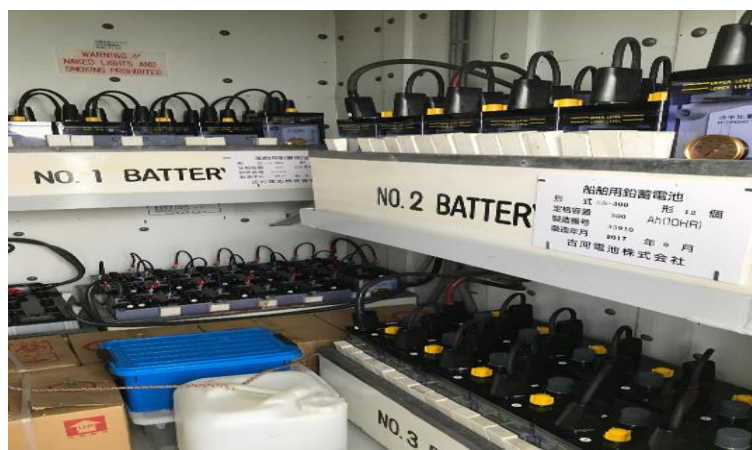
故障時用の蓄電池
